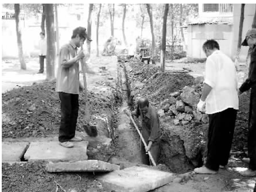
施工人员对五松西村43栋旁的一条长长的水沟进行清理和修葺的情景。
