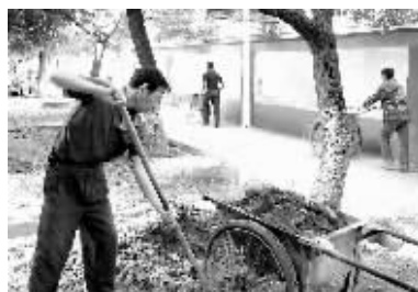
10月7日,在石城新村内,工作人员正在进行小区的路面和管网施工。据了解,国庆中秋假期,承担我市多个小区改造工作的施工人员,没有休息一天,一直在紧锣密鼓地施工,力争早日完工,方便居民生活。 本报记者 过仕宁 摄
