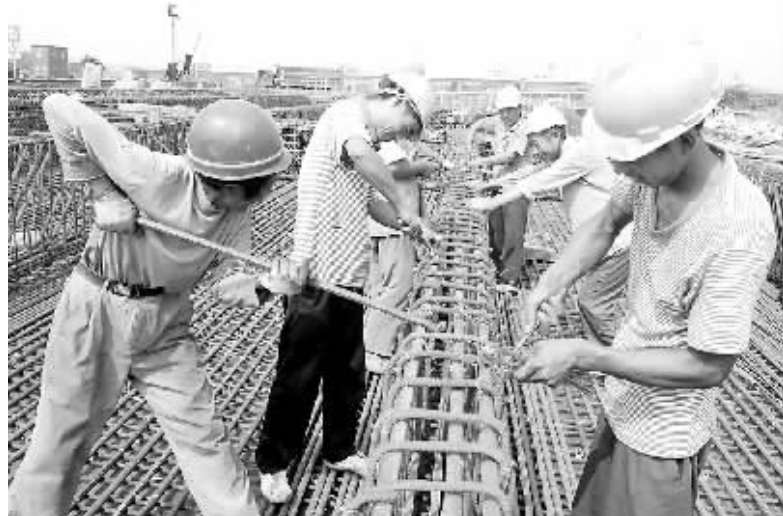
国庆、中秋长假期间,中铁二十四局建设者奋战在重点工程沿新路立交桥工地上。据了解,沿新路立交桥、宁安城际铁路等重点工程建设者,放弃休息,坚守岗位,以实际行动庆祝新中国60华诞。 本报记者 过仕宁 摄
